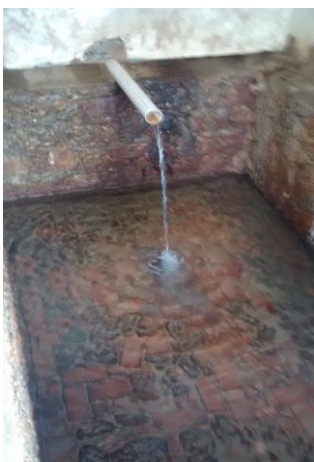
Foto 10 – Abastecimento do reservatório
